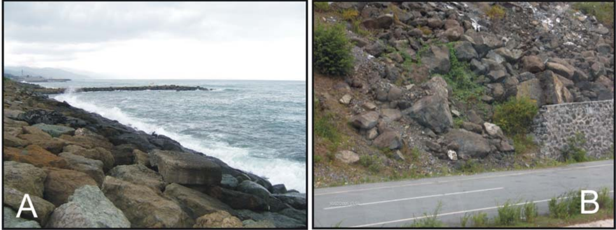
Foto 6: A-Yol platformunu koruma amaçlı kaya tahkimatlar ve “T” mahmuzlar. B- Yoğun çatlakların günlenme ile tetiklendiği yamaç problemleri.
