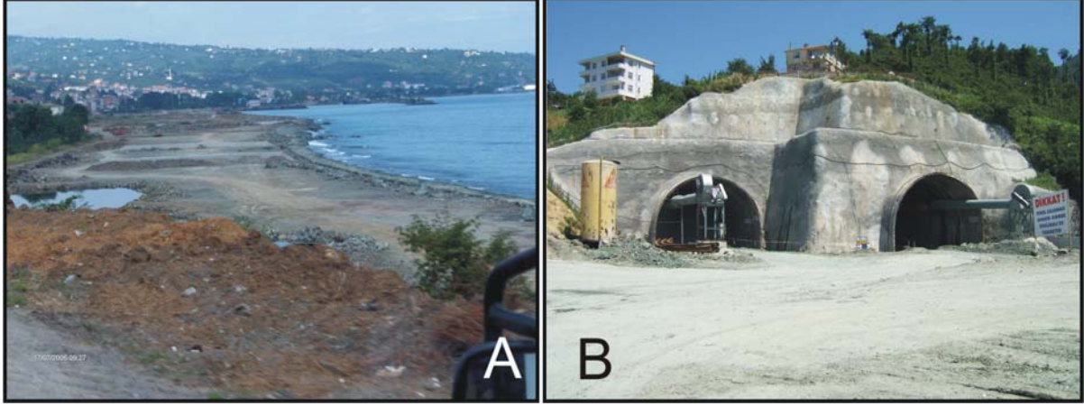
Foto 4 a-b: A-Denizel kıyıda yapılan dolgular ile yol platformu için kazanılan alan ve değiştirilen kıyı çizgisi. B- Etki alanı için inşaatı sırasında ve sonrası için ciddi problemlere neden olan tünel inşaatları.
