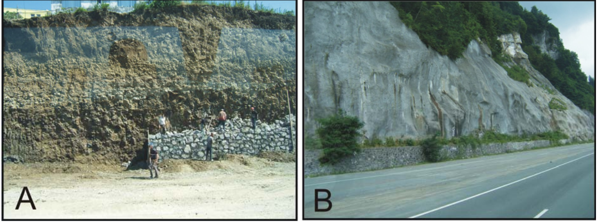
Foto 1a-b: Yol platformu için yapılan yamaç hafriyatları ve yamaç dengesini koruma çalışmaları.
