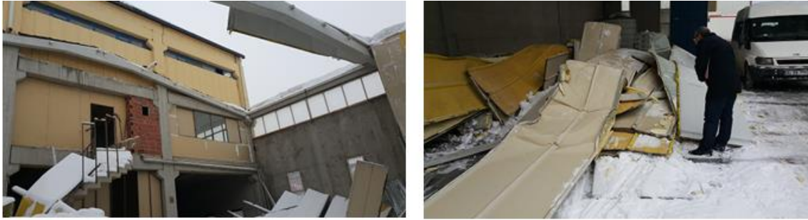
Şekil 1. KONSAN sanayi sitesinde bulunan sanayi yapısının kar yağışı sonrası göçmüş haldeki görünümü
