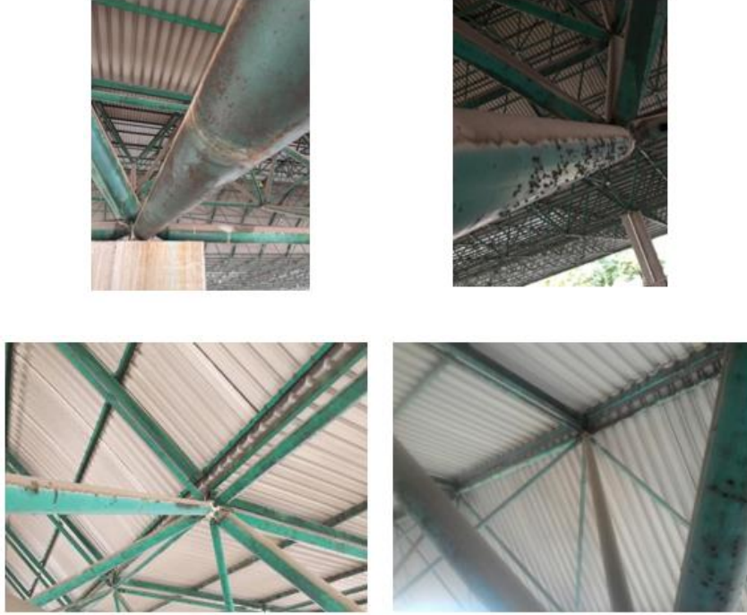
Şekil 9. Taşıyıcı boru kesitli elemanlarda oluşan korozyon/paslanma
